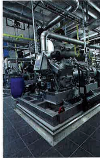
Die Fleischtrocknerei Churwalden in der Schweiz heizt und kühlt in Kombination.
